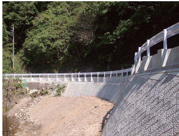
積ブロック直上設置の事例
