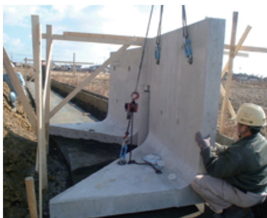
③フリーコーナー (A) 設置状況
